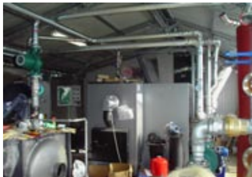
Figura 26. Caldaia per la produzione di acqua calda da 200 kW.
